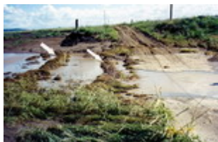
Un torrente de 2 m de agua pasó sobre este badén en una granja en Australia. Las plantaciones en contorno de Vetiver fueron colocadas aguas arriba y cerca del cruce, dando como resultado que la velocidad del flujo de agua no pudiera provocar el socavamiento y romper el
